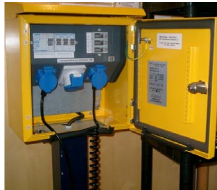
Stromtankstelle 3phasig mit Zählern
